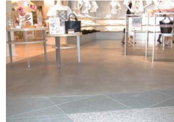
店舗床劣化防止
